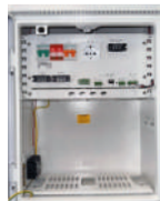
PREDISPOSTO PER ALTRI SWITCH
