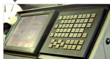
CENTRALE DI SORVEGLIANZA
