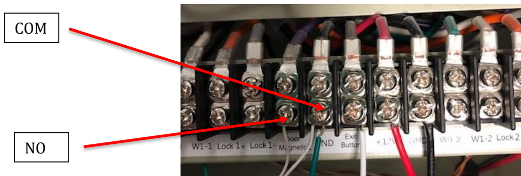
Figura 1: collegamento sul controllore del sensore magnetico (cavi bianchi) tra GND (COM) ed “Door Magnetic 1” (NO) per gestire il varco 1
