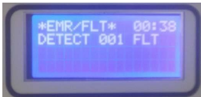
Fig. 3-6) Videata in stato di Guasto
