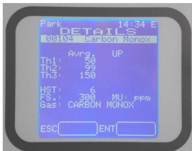
Fig. 3.8.3 c) Dettagli configurazione rilevatore gas
