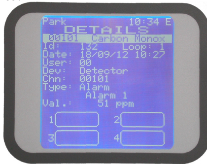
Figura 22) Dettagli evento di Allarme 1
