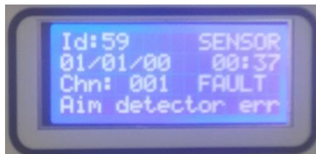
Fig. 3.2.1.e) Dettagli evento di Guasto
