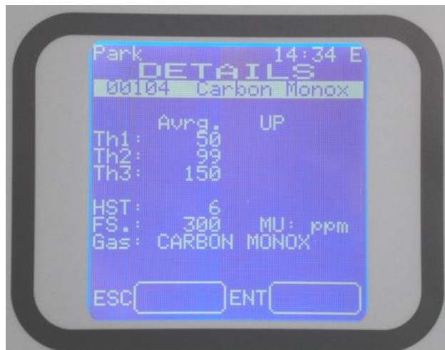
Fig. 3.8.3 c) Dettagli configurazione rilevatore gas
